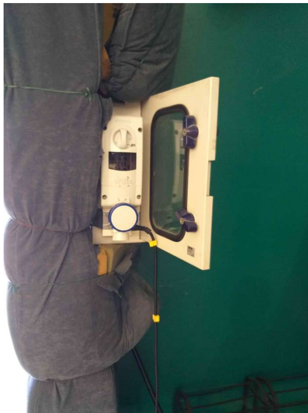
Contatore energia elettrica all'interno della tenso-struttura
