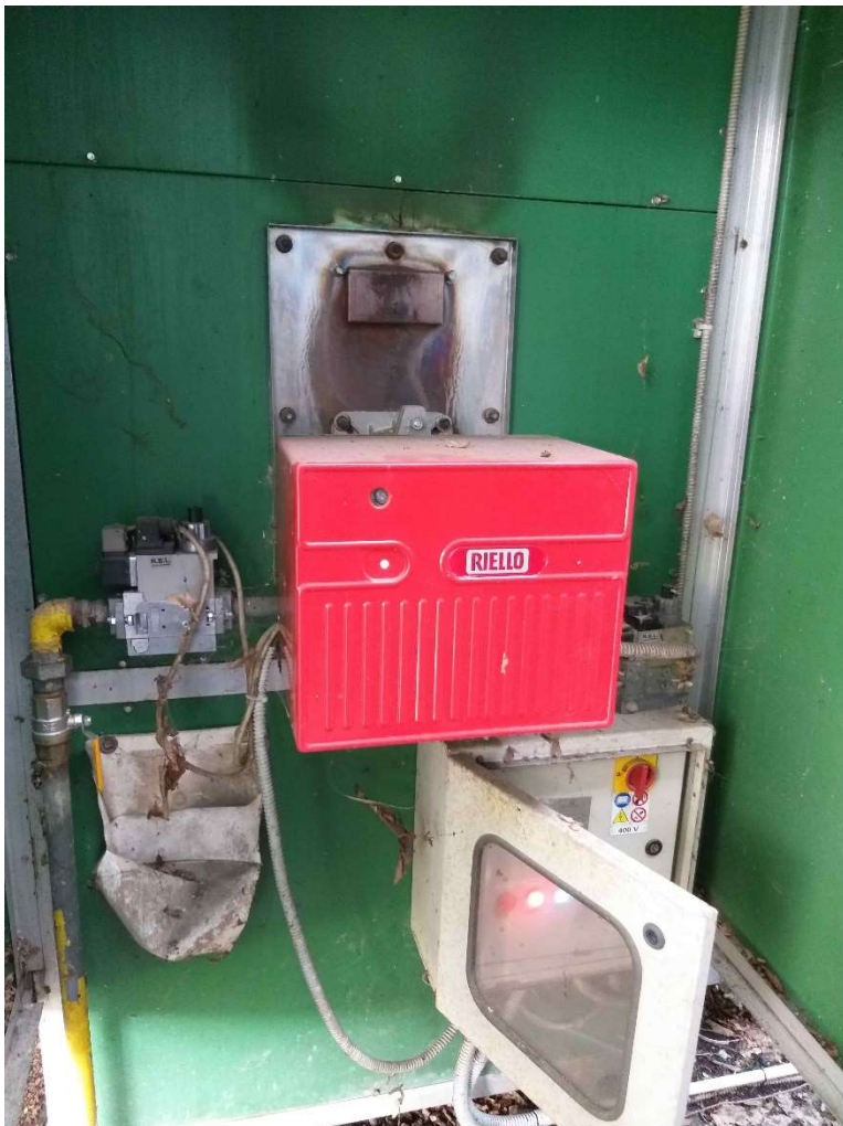
Bruciatore per tenso-struttura
